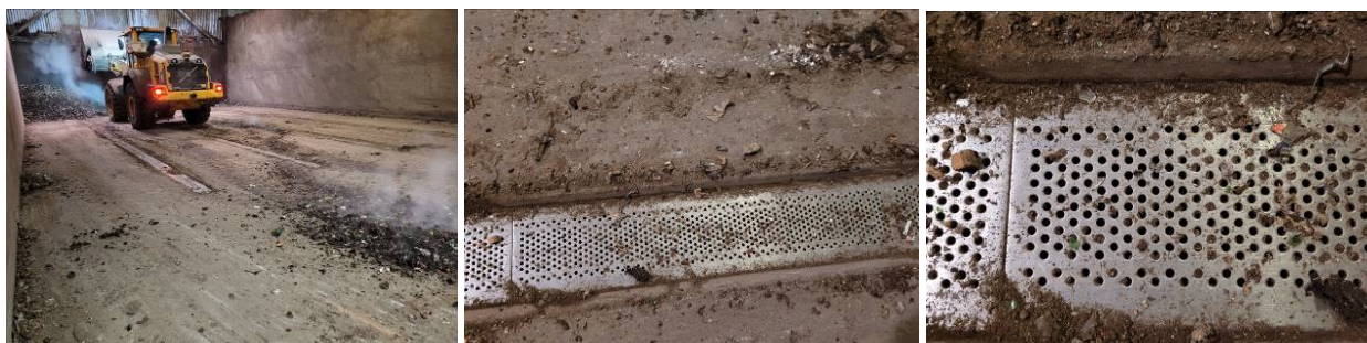
Constat des grilles de caniveau lors d'un retournement depuis un tunnel
