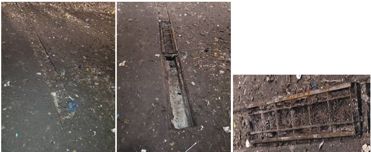
Clichés des grilles d'aération des caniveaux lors d'un retournement entre 2 tunnels.
