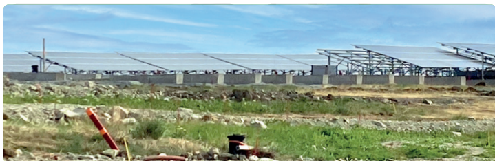
Atelier énergies renouvelables : Photovoltaïque
